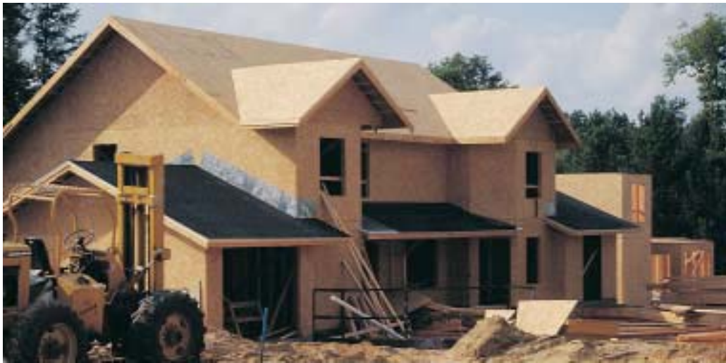
Πηγή: OSB Engineered to Perform for Housing and Construction. Εικ. 11. Επένδυση εξωτερικής τοιχοποιίας και σκεπής από OSB.
