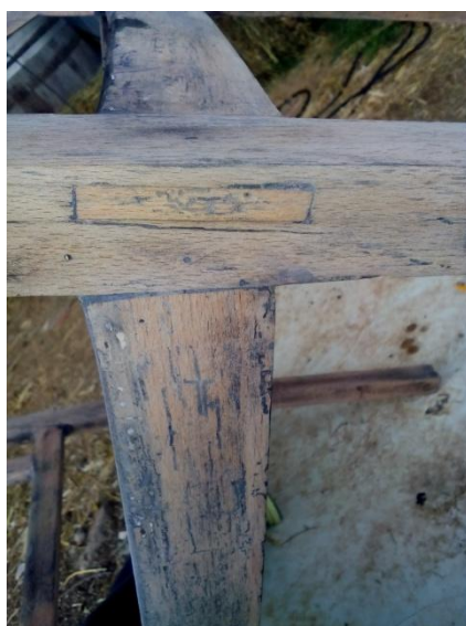
Εικόνα 102 Προηγούμενη επισκευή μόρσου-εγκοπής
