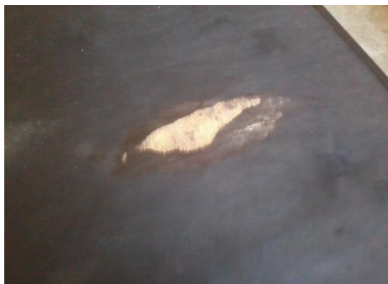
Εικόνα 92 Παρατήρηση φουσκώματος καπλαμά στην επιφάνεια
