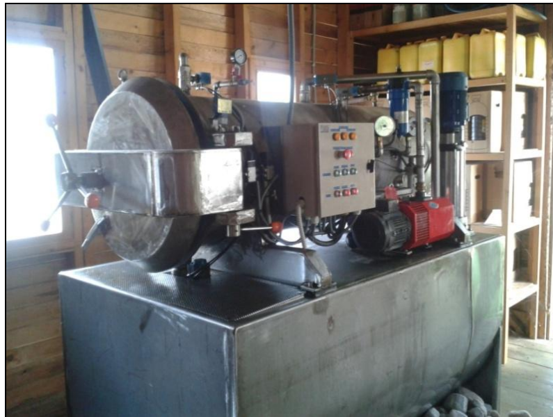
Εικ. 55. Εργαστηριακός θάλαμος εμποτισμού ξυλείας.
