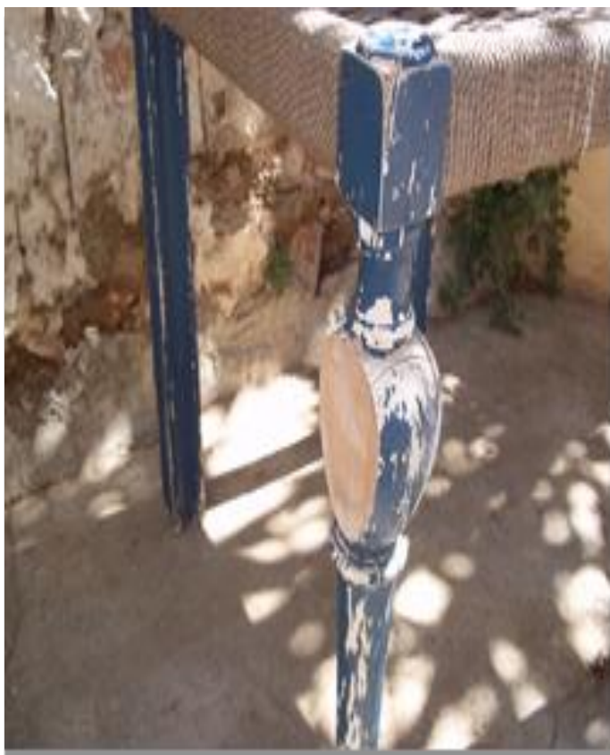
Εικόνα3.3 Φθορά του χρώματος
