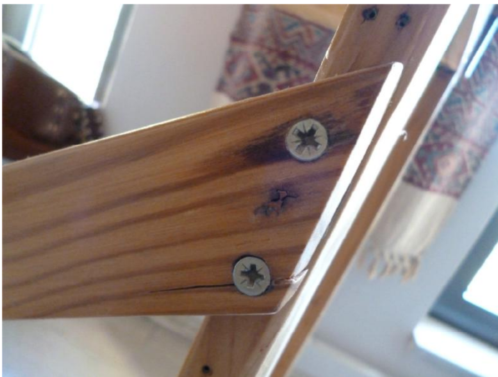
Εικόνα 4.8. Στις χιαστί τραβέρσες φαίνεται ότι υπήρχαν παλαιότερα καρφιά που τις συγκρατούσαν με τα πίσω κάθετα πόδια. Μεταγενέστερα, προφανώς η θέση των χιαστί ξύλων μετακινήθηκε λίγο και τοποθετήθηκαν σε αυτά βίδες.
