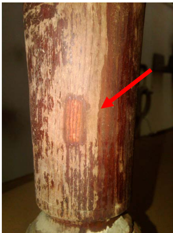
Εικ. 3.1.10: Εμφανής έντονη δράση του μίγματος ακετόνης/ white spirit 1/1 και ανεπιθύμητα αποτελέσματα λόγω αφαίρεσης και της αρχικής βαφής
