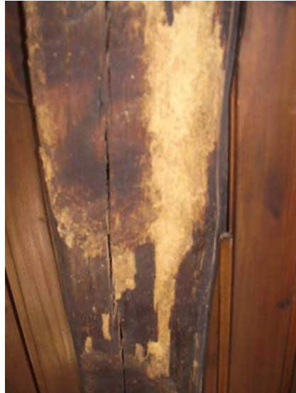
Εικόνα 52. Ι.Μ. Ρουσάνου-Έντονη αποσάθρωση από ξυλοφάγα έντομα
