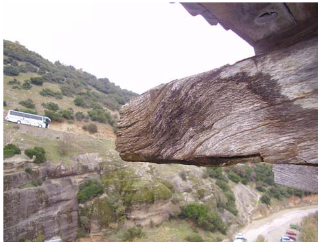
Εικόνα 36. Ι.Μ. Βαρλαάμ-Έντονα φθαρμένο δοκάρι στέγης σε εξωτερικό χώρο
