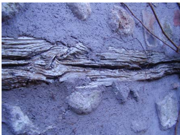
Εικόνα 61 I.M. Μ. Μετεώρου-Ξυλοδεσιά με πολύ έντονες ραγάδες κατά μήκος των ινών και εμφανή τα σημάδια της φθοράς λόγω των κλιματικών εναλλαγών
