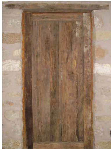
Εικόνα 22. Ι.Μ. Μ. Μετεώρου-Ξύλινη πόρτα, τα κενά μεταξύ της κάσας και του τοίχου, έχουν κλείσει με αφρώδες υλικό
