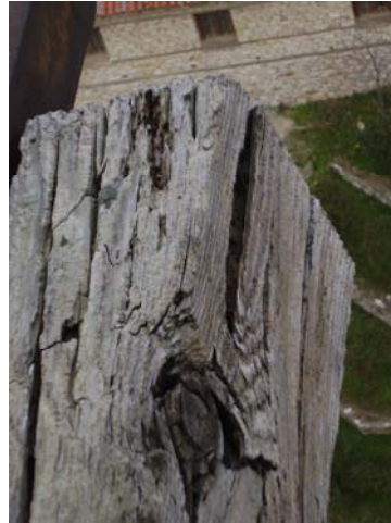
Εικόνα 27. Ι.Μ. Μ. Μετεώρου-Έντονη αποσάθρωση, αποπίπτοντας ρόζος και βαθιές ραγαδώσεις
