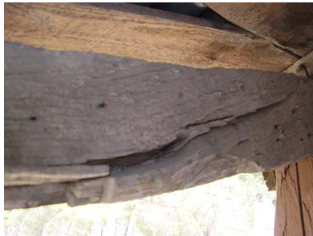
Εικόνα 39. Ι.Μ. Βαρλαάμ-Μεγάλη ρωγμή σε δοκάρι στέγης
