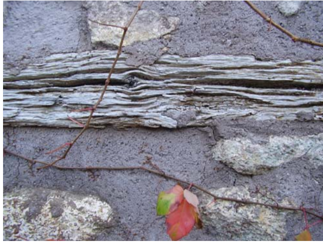
Εικόνα 15. Ι.Μ. Μ. Μετεώρου-Ευλοδεσιά με πολύ έντονες ραγάδες κατά μήκος των ινών και εμφανή τη φθορά λόγω των κλιματικών εναλλαγών
