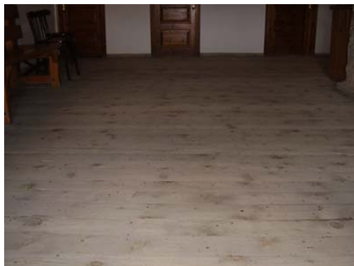
Εικόνα 60 I.M. Ρουσάνου-Ξύλινο πάτωμα έξω από το καθολικό της μονής, στο σκελετό του σώζονται μόνο ελάχιστα από τα παλιά δοκάρια, διότι το μεγαλύτερο μέρος του είχε καταρρεύσει και αντικαταστάθηκε
