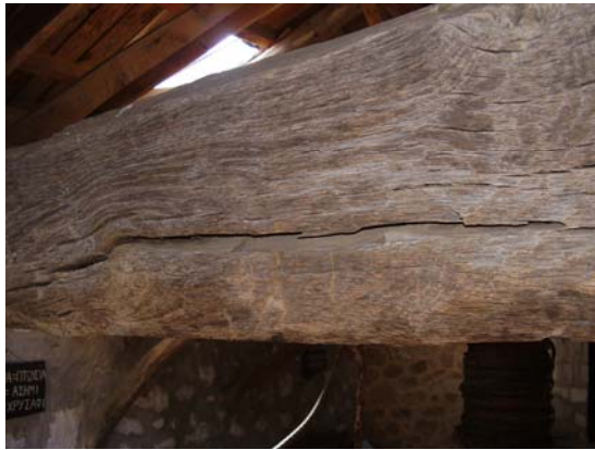
Εικόνα 4 Ι.Μ. Αγίας Τριάδος-Δοκάρι στέγης του κεντρικού διαδρόμου
