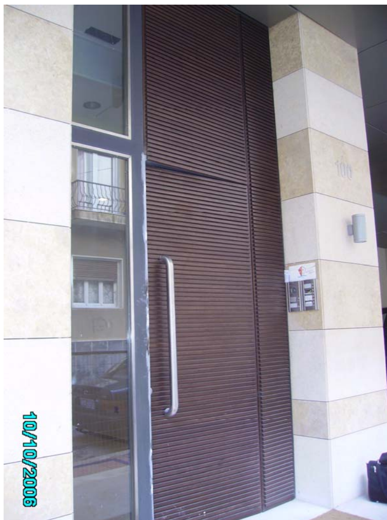
15. Πόρτα ασφαλείας εισόδου καταστήματος με σταθερό αριστερά.
