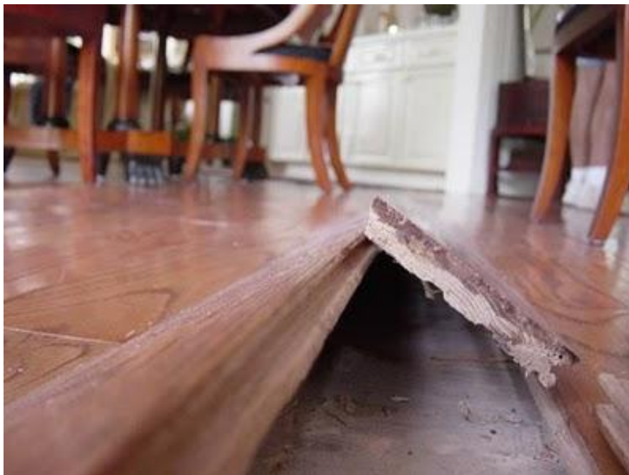
Εικόνα 20. Αποτέλεσμα τοποθέτησης κολλητού δαπέδου σε τσιμεντοκονία με υψηλό ποσοστό υγρασίας.
